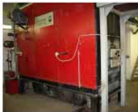
Kotel vytápějící 60 budov v obci Hostětín
